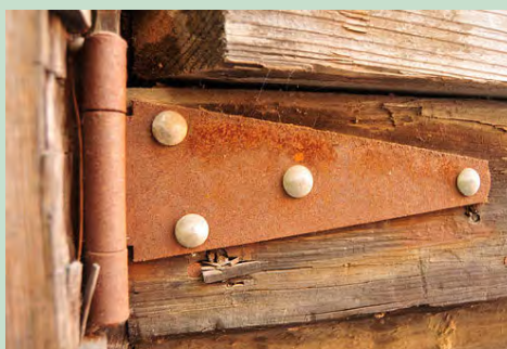
A rusted door hinge.
