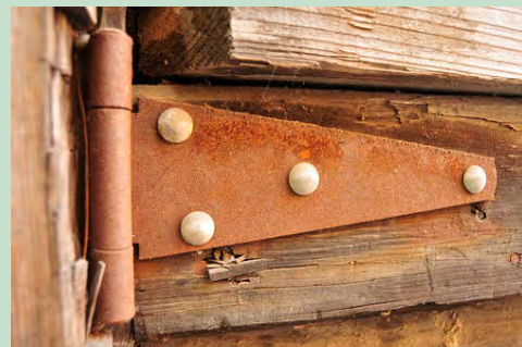
A rusted door hinge.
