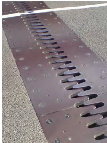
Die uitsettingslas in 'n brug.
