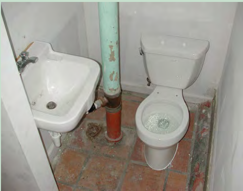
'n Wasbak en toilet.
