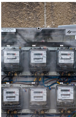
Figuur 4.3: Elektrisiteitsmeters buite 'n gebou
