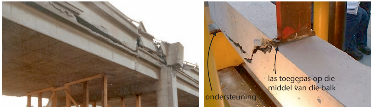
Figure 5.7 Faling as gevolg van afskuiwing in 'n betonpilaar en 'n -balk
